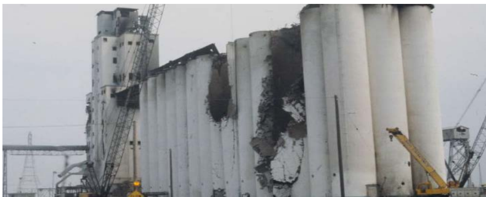
Рис. 2. Фрагмент последствий взрыва на элеваторе
