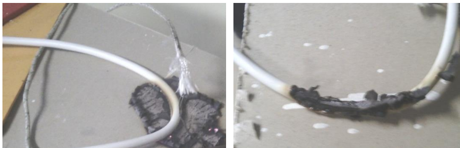
Rys. 4. Skutki przegrzania nieogrzewanej warstwy ścianki
